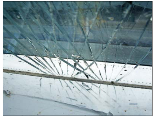
Примеры разрушения стеклопакетов из-за ошибок монтажа.
